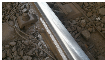
図 13 側摩耗したレール Side worn rail
