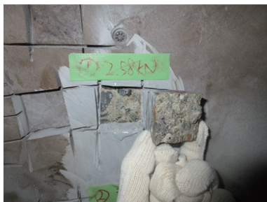
写真10 破壊状況 Destruction state
