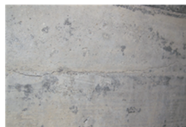
写真4 ひび割れの状況 Crack state
