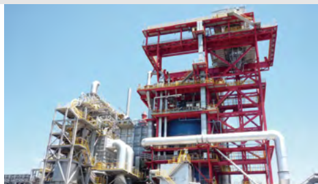
コークスの熱エネルギーを回収し製鉄所からのCO 2 排出量削減に貢献する、コークス乾式消火設備(CDQ)
