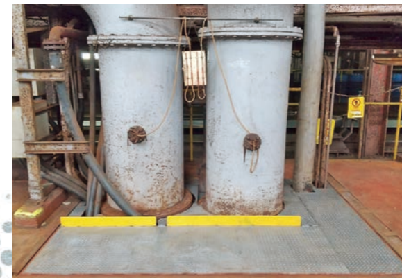
■ 工場設備床材 (ZEXEED®縞板)
