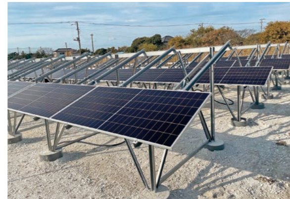
■ 太陽光発電架台 / 千葉県木更津市
