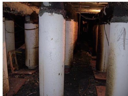
写真 4 スキッドサポート実機施工後写真 Skid-supports after 5 years in the furnace of the hot-strip mill
